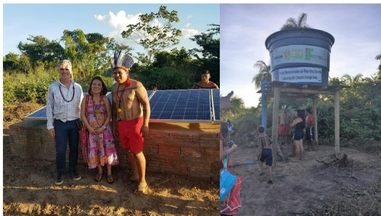
Figura 5. Foto à esquerda: Ben Colombi e Karletta Chief, Professores da Universidade do Arizona, ao lado do Chefe Xerente perto dos painéis solares que bombeiam a água do rio. Foto à direita: O tanque de armazenamento de água com os representantes da Rede Internacional de Pesquisa sobre Barragens Amazônicas explicando o sistema de bombeamento e irrigação movido à energia solar.
