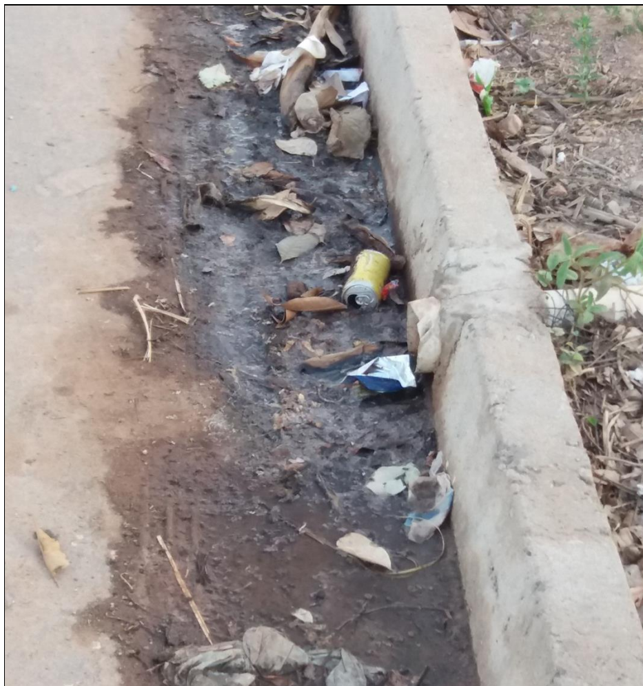
Figura 10 – Esgoto a céu aberto em rua pavimentada com cano despejando dejetos.
