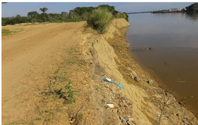
Figura 22 - Ausência de vegetação adequada - bairro: Amapá
