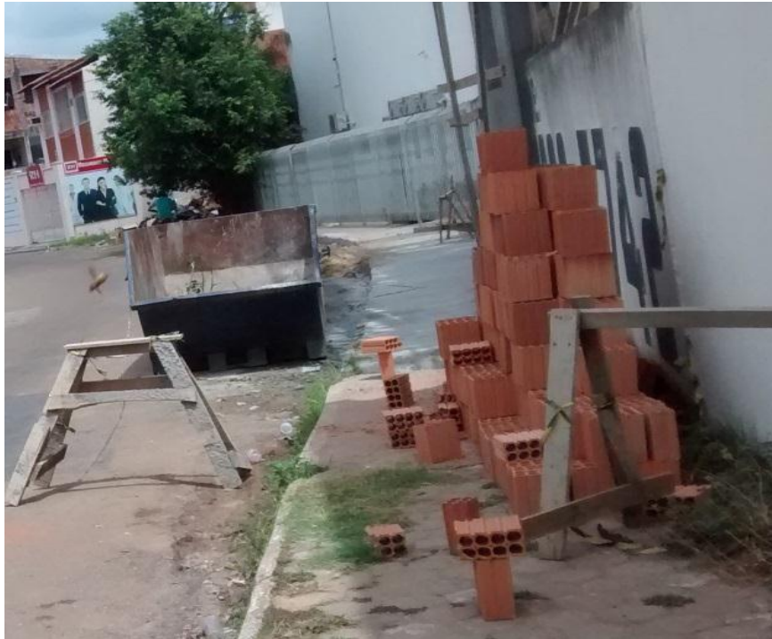
Figura 5: Passeio público em Marabá, obstruído com materiais de construção.
