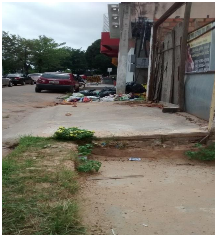
Figura 19: passeio público sem condições de acesso ao pedestre.
