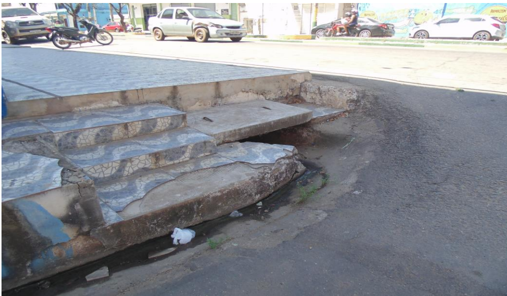
Fotos 17- Irregularidades no piso- Fonte:Barbosa,2018
