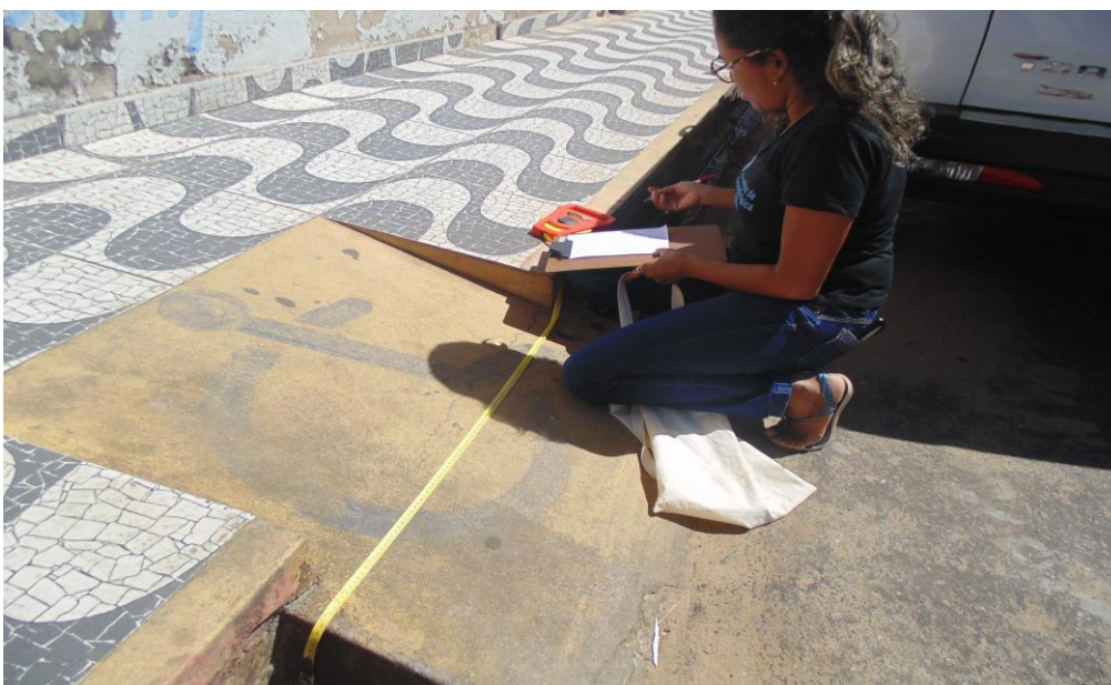
Fotos 18- Irregularidades no piso- Fonte: Barbosa,2018
