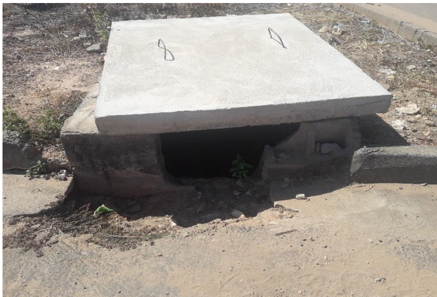
Figura 2. Bueiro que é ligado ao sistema de coleta de águas pluviais do Loteamento Vale do Tocantins.
