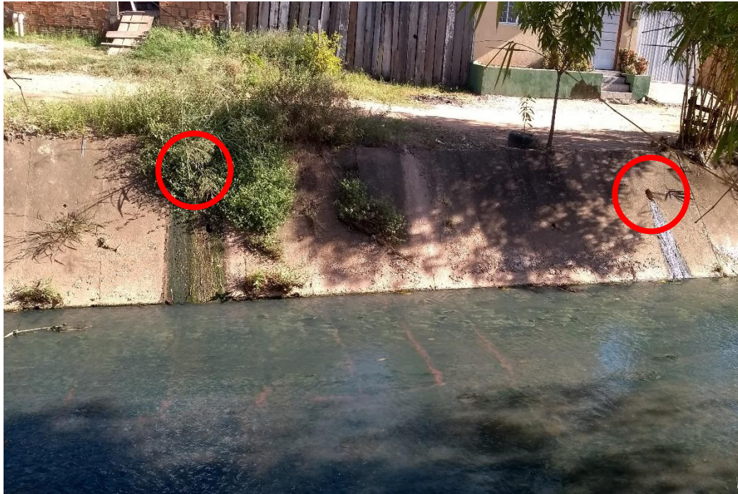
Figura 2.3: Canos de esgoto vindo das residências.
