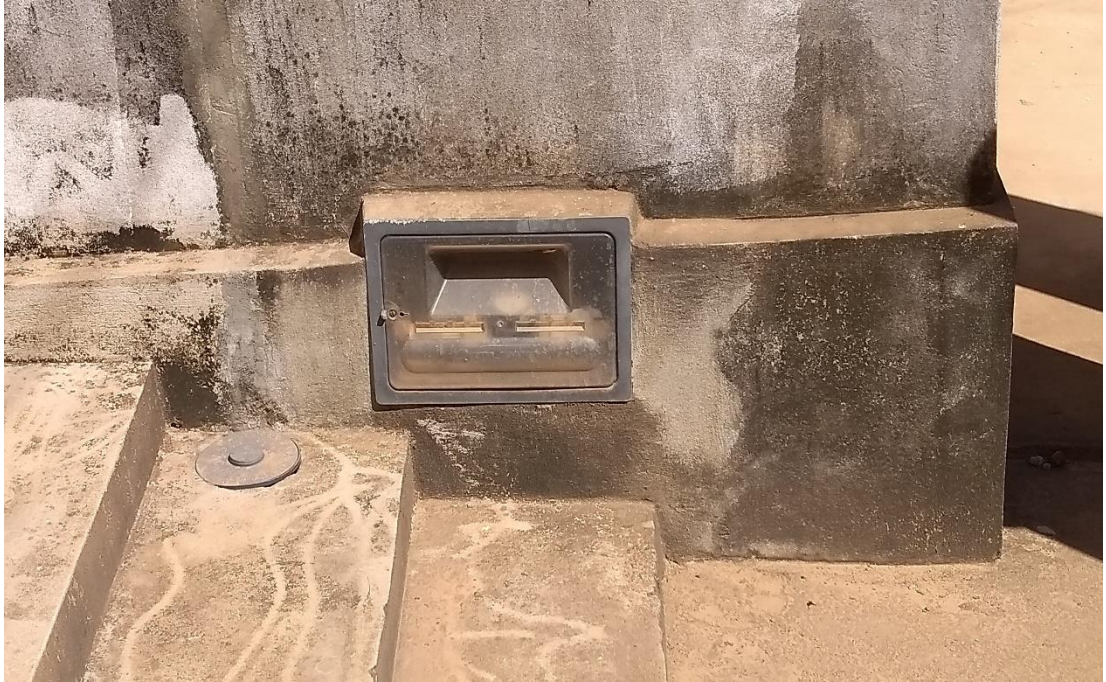
Figura 2.7: Relógio instalado pela Cosanpa para medir o consumo de água.
