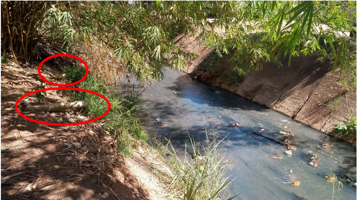
Figura 3.2: Canos expostos vindos das residências para lançar esgoto no interior da grot.
