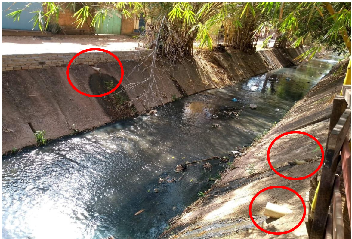
Figura 2.2: Canos lançando esgoto das residências no interior da Grotta.
