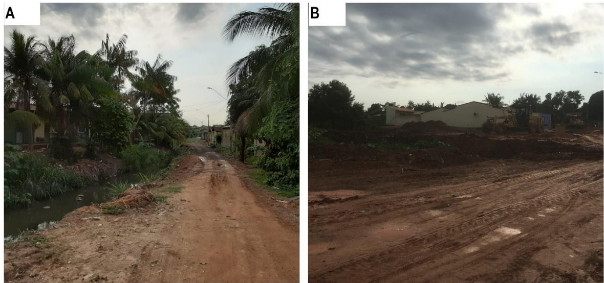
Figura 06: A) margem do canal sem presença de mata ciliar, no medio curso da grota; B) obras de drenagem no baixo curso
